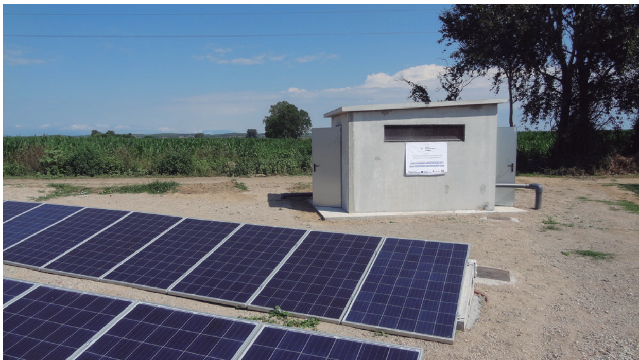
Figura 22.- Instal·lació dels panells solars i la caseta de reg de la superfície de reg.
