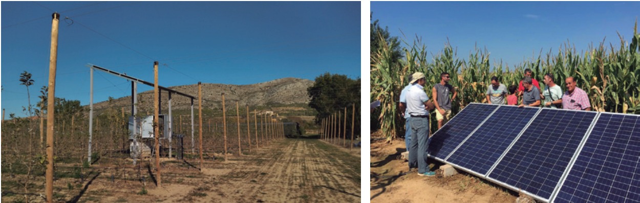
Figura 23 i 24.- Exemples de diferents instal·lacions de bombament solar per transformar el reg tradicional a reg localitzat en els cultius de blat de moro (Casavells) i en fruiters (Ullà).
